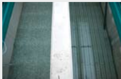
De installaties van Bennekom en Woudenberg hebben vier zandfilters, ruim voldoende capaciteit om fluctuaties in het aanbod op te vangen.
