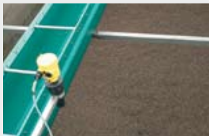
Het 1.80m hoge zandfilter ligt klaar voor gebruik: 120 ton zand, met een korrel diameter van 2-3 millimeter.
