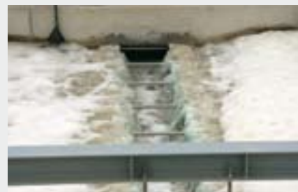
De goten vangen in de lucht/waterfase het terugspoelwater op. Het filter is weer schoon en klaar voor gebruik.
